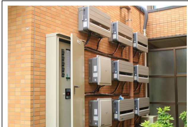
「発電所 4 号機」 パワーコンディショナー
