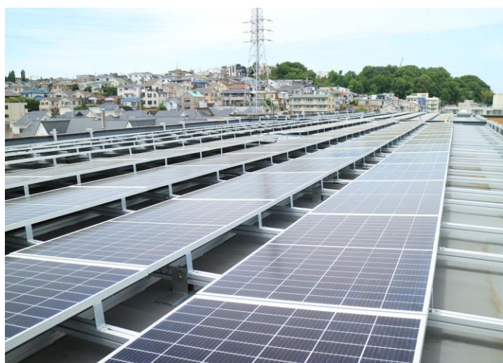
「発電所4号機」パネル219枚、発電出力49.5kW 世帯に換算すると約18世帯分の電気を発電（年平均）
