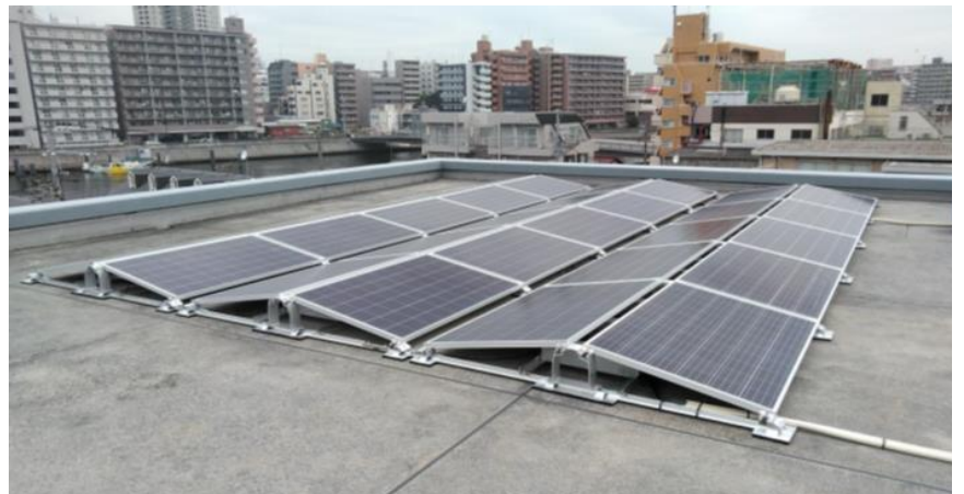
「うしおだ診療所」屋上 太陽光パネル設置状況（パネル48枚のうち30枚分）
