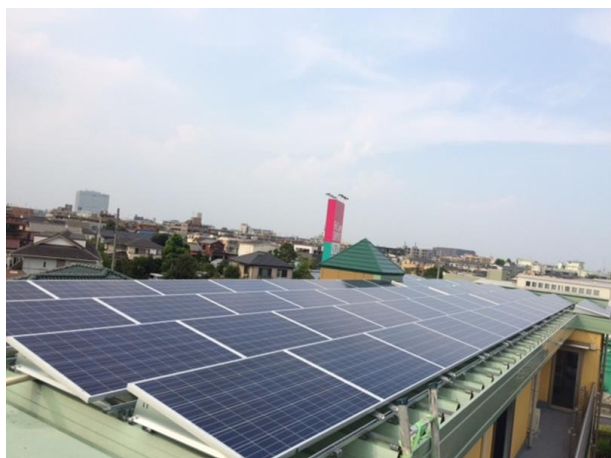
COCOせせらぎ 屋上に設置した太陽光パネル
